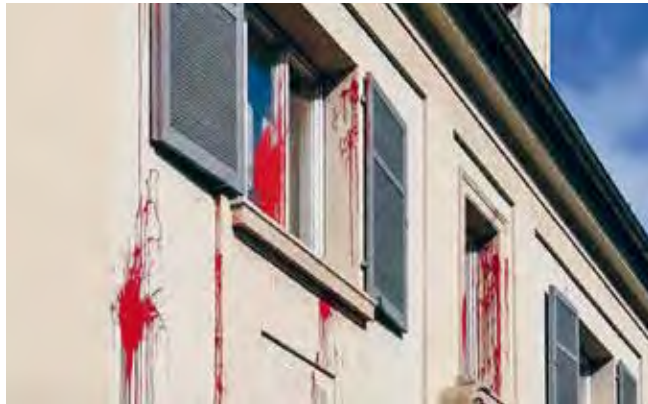
4 Farbangriff auf das Amtsgericht Waiblingen
